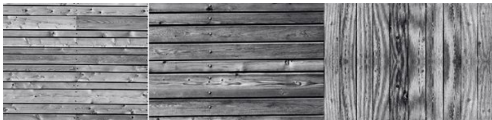
Příklad stárnutí dřevěné fasády
